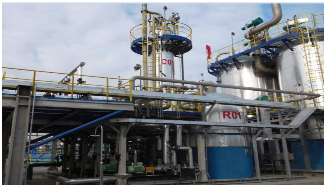
图 3-2 炼油 VOCs 废气处理设施-1
