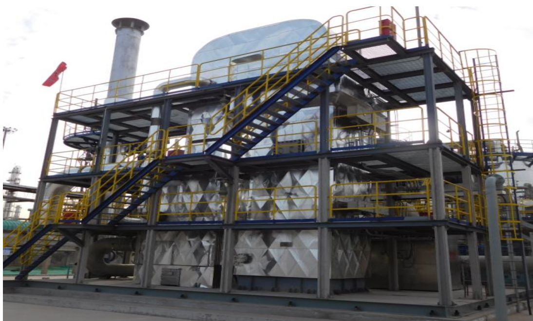
图 3-3 炼油 VOCs 废气处理设施-2
