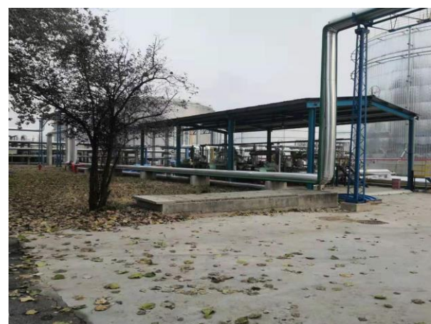
图 2-7 罐区配套设施
