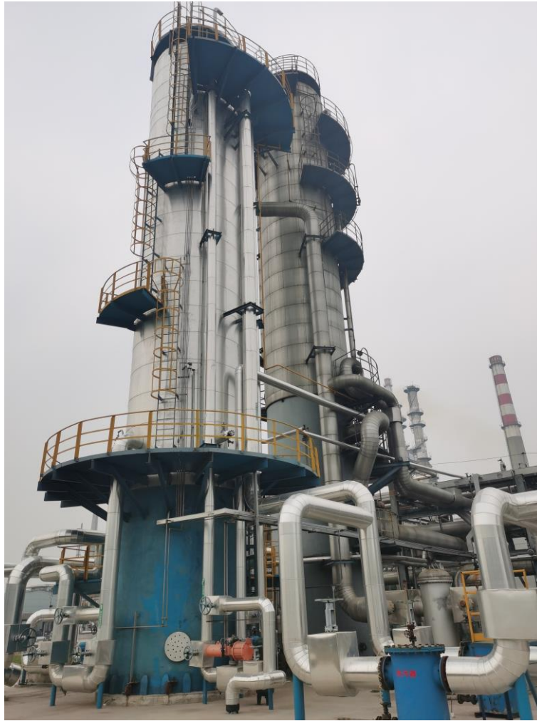
图 2-3 新增 50m 3 热水缓冲罐（左侧）
