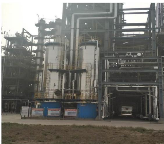
重整装置催化剂再生烟气氯吸附设施
