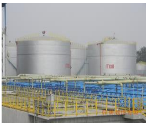
含盐处理系统一体化处理池、含盐含油 污染雨水及事故水调节储罐
