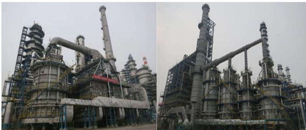
图 4.1-4 2#常减压装置加热炉连续重整装置加热炉
