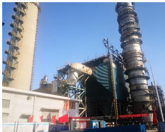
哈蒙电除尘和脱硫脱硝综合治理设施 (220 万吨/年催化)
