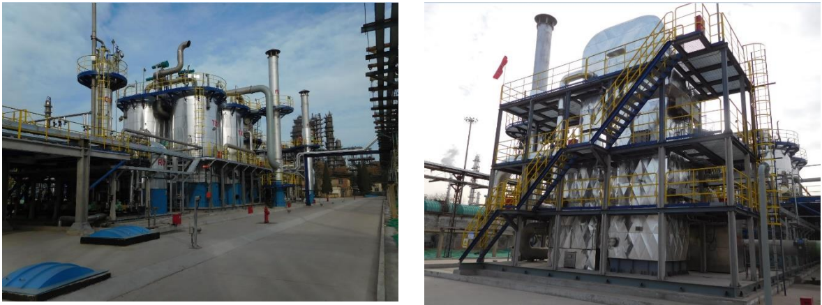
图 4.1-8 炼油 VOCs 废气处理设施
