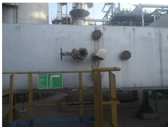
图 4.2-3 手工监测取样口
