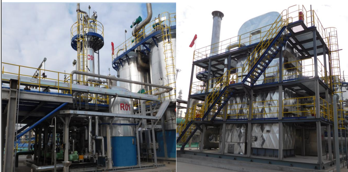
图 3.2 炼油 VOCs 废气处理设施现场照片
