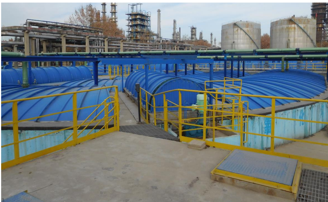
图 3.9 氧化沟加盖及废气收集管网
