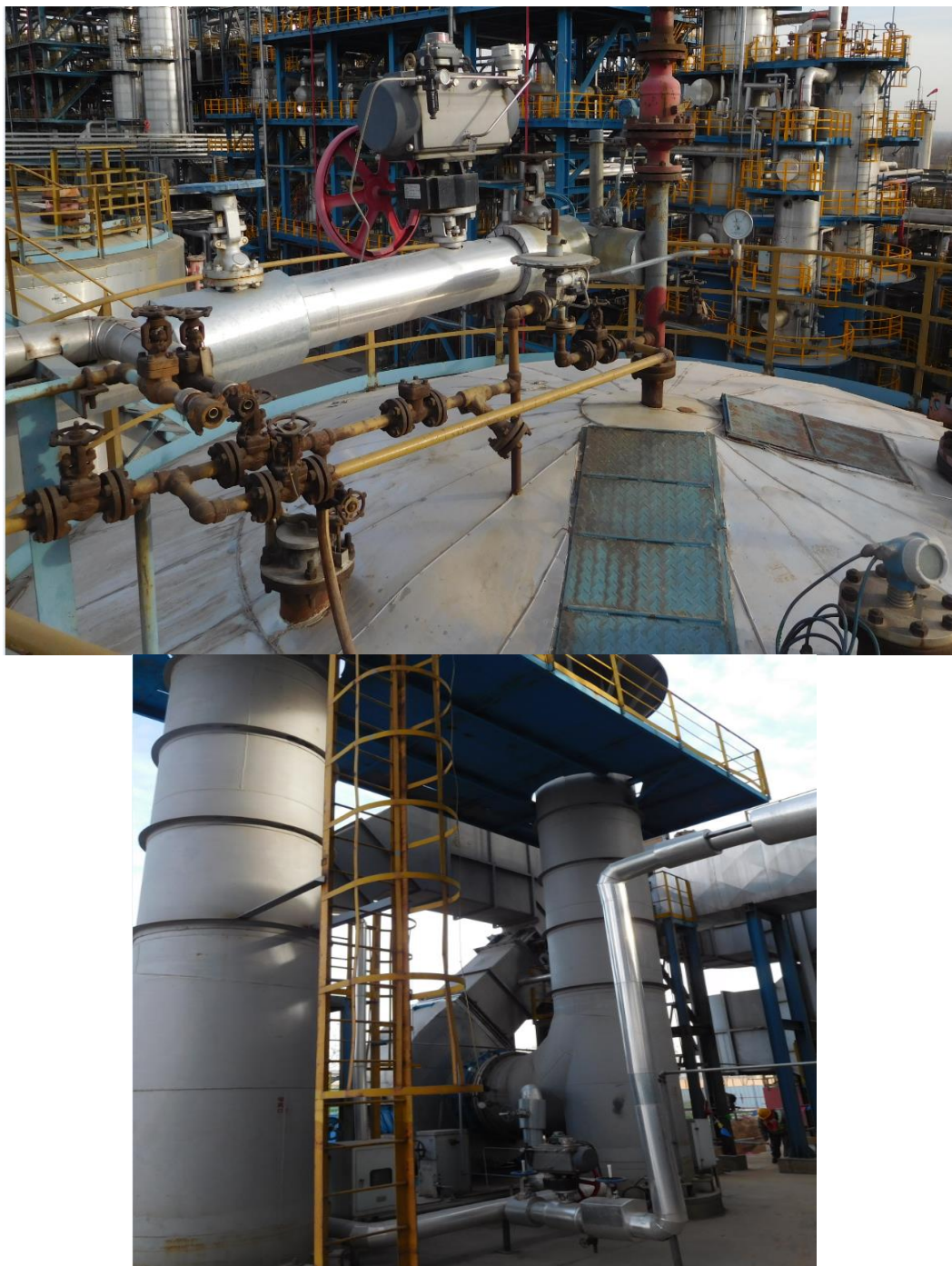
图 3.12 重整中间罐废气收集及处理设施
