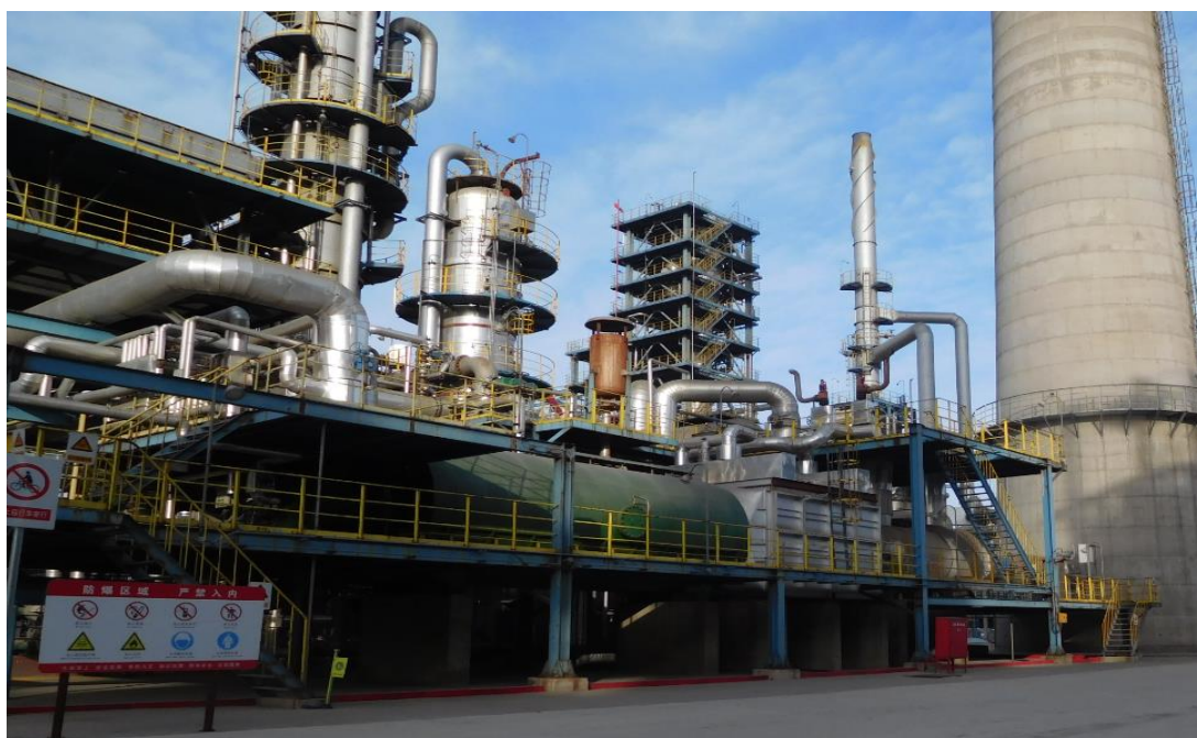
图 3.12 1#酸性水汽提装置原料水罐废气处理流程及现场照片
