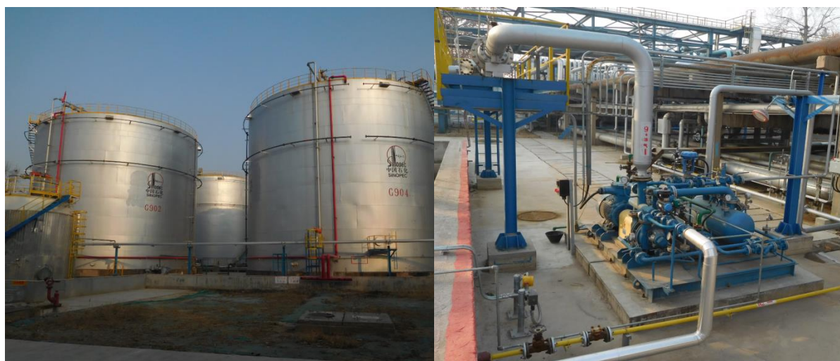
图3.4 9#罐区废气收集及增压设施
