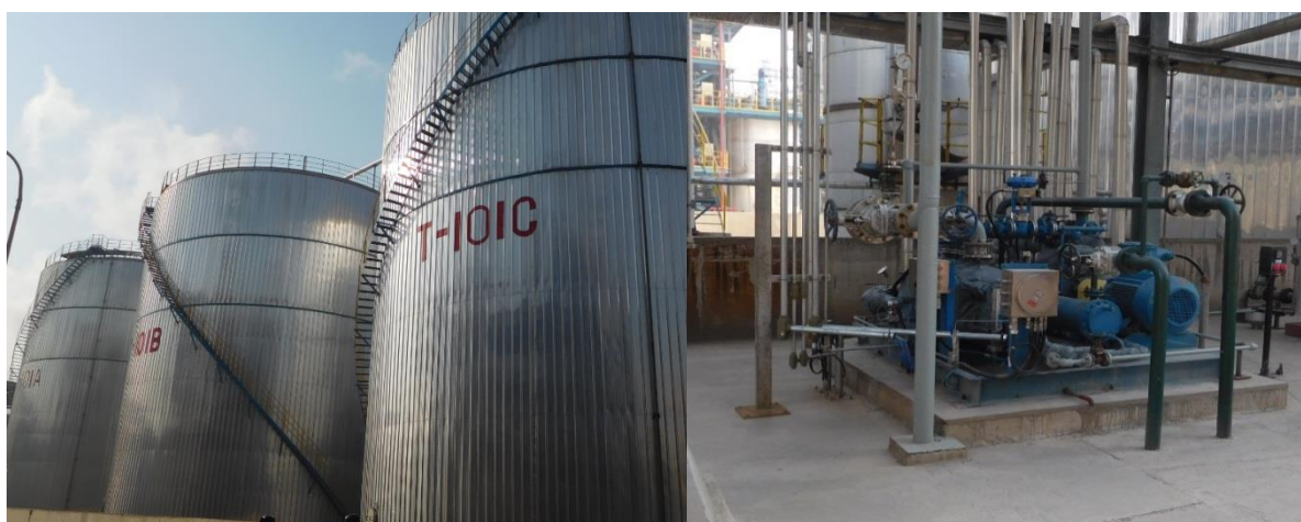
图3.5 2#酸性水汽提装置酸性水罐区废气收集及增压设施
