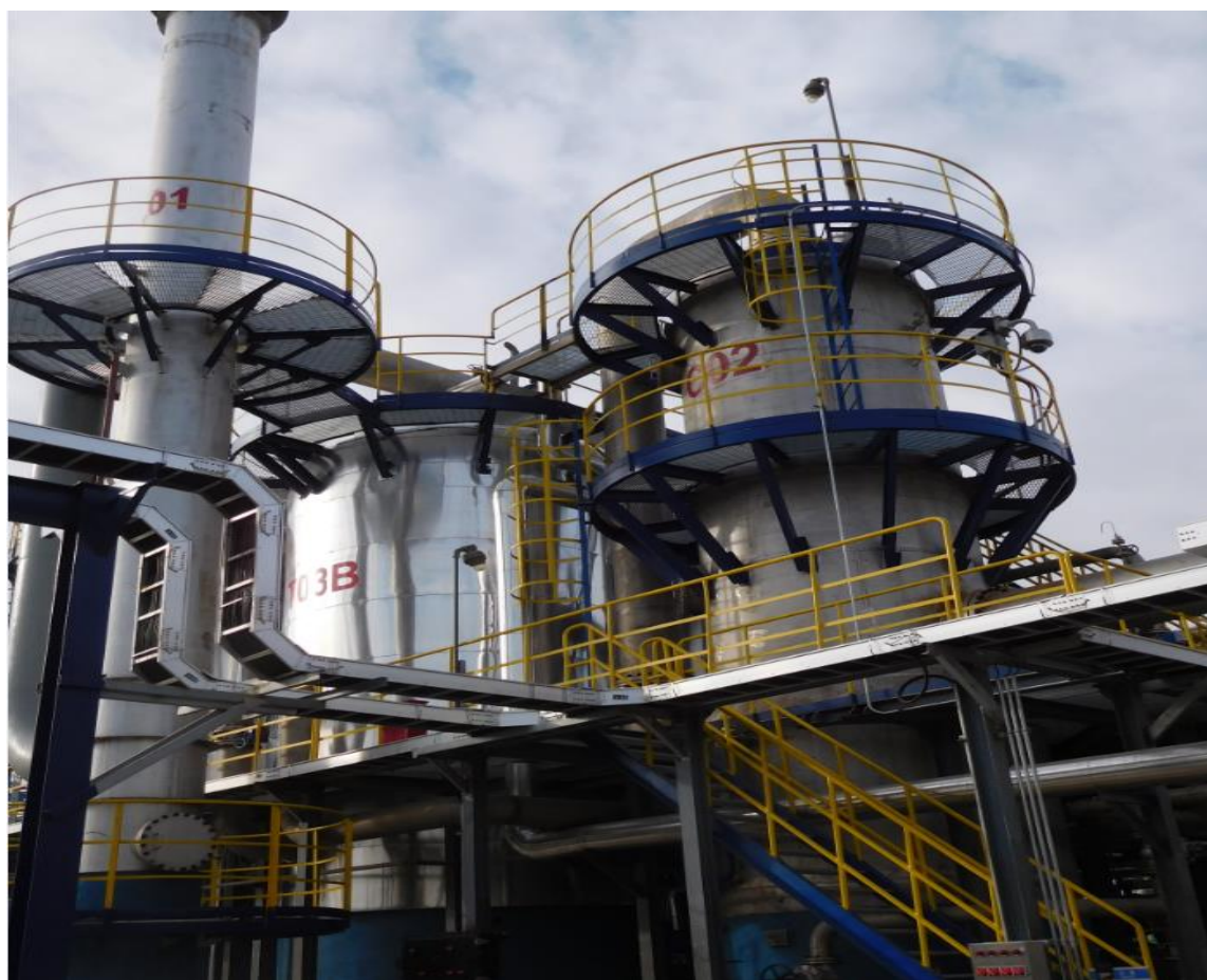
图 3.10 氧化沟废气处理设施
