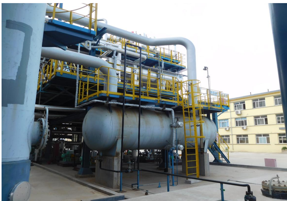
图 3-6 烷基化装置低压瓦斯（含烃气体）分液罐
