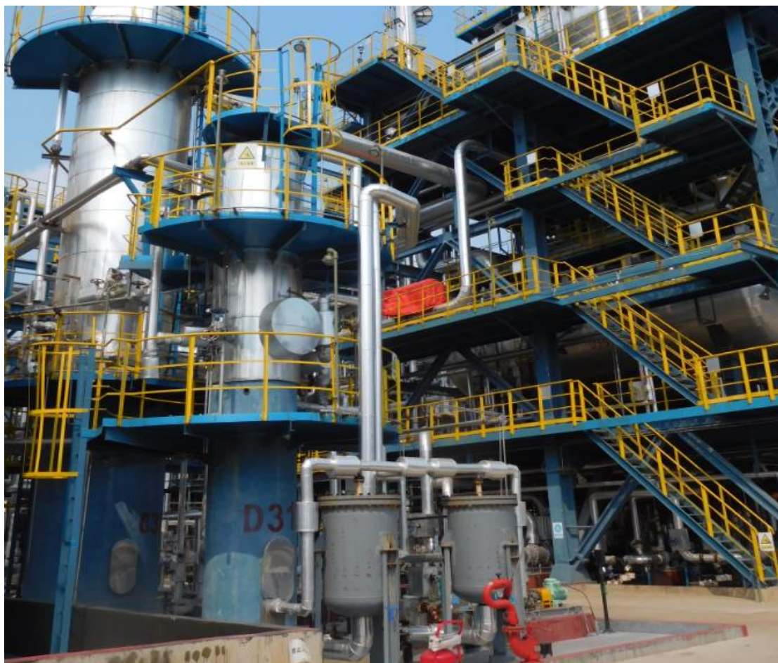
图 3-5 烷基化装置硫酸储罐废气处置设施
