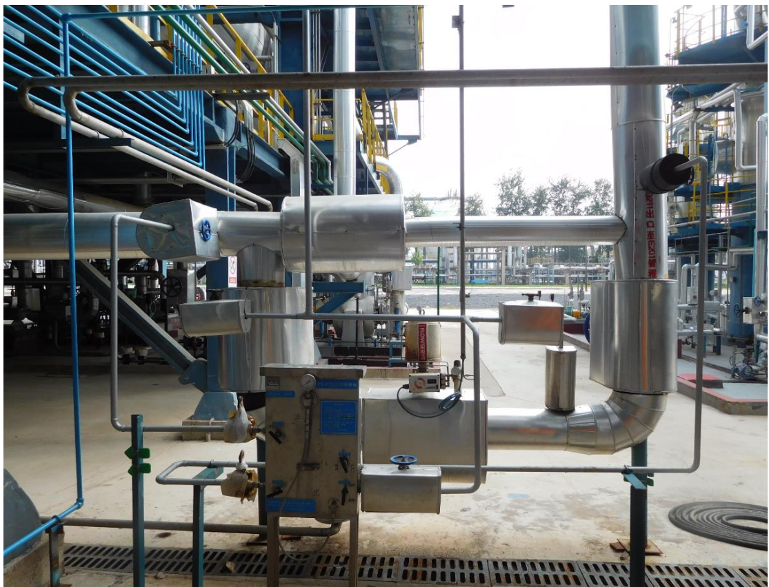
图 3-8 烷基化装置密闭采样器
