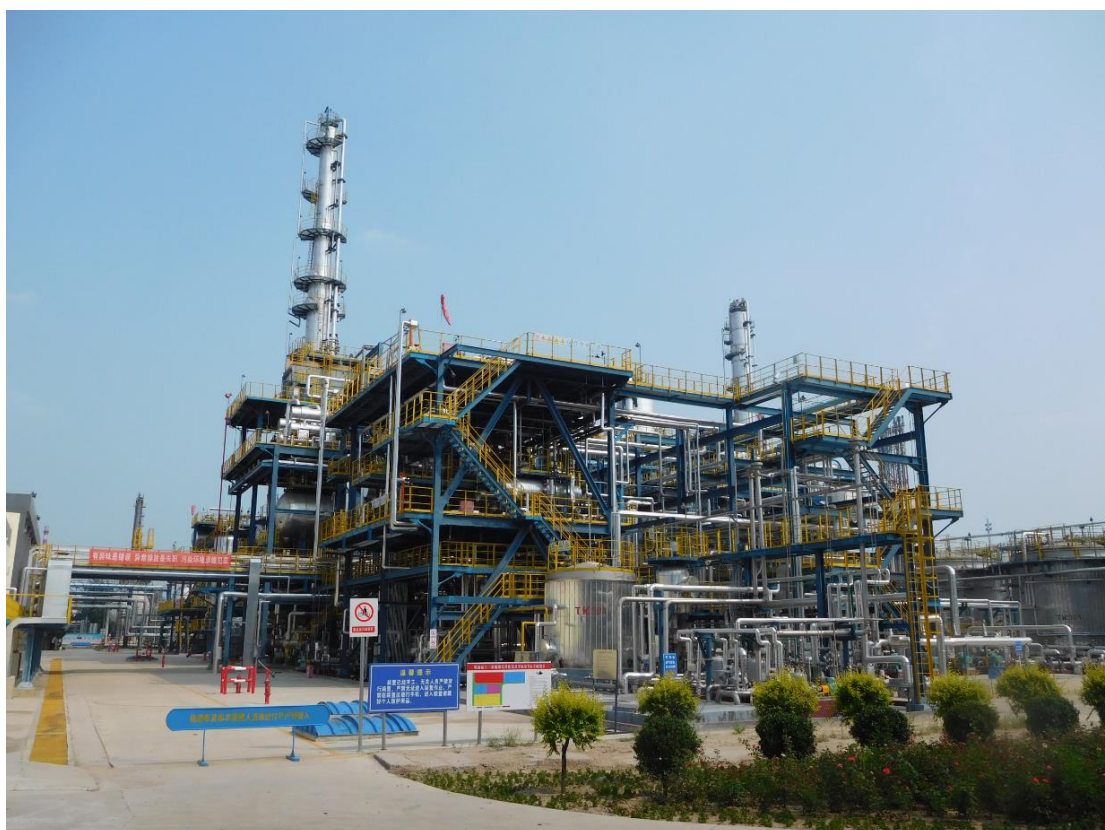
图 3-1 汽油质量升级烷基化装置全貌
