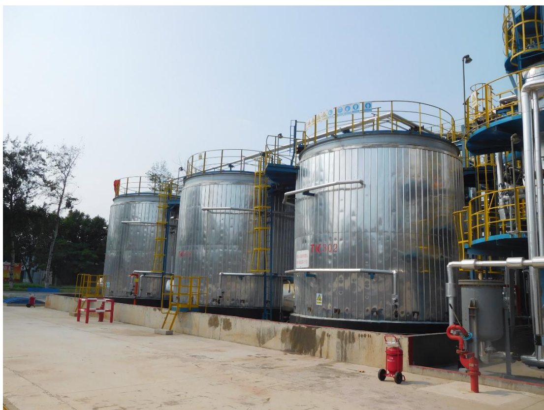
图 3-4 烷基化装置硫酸储罐
