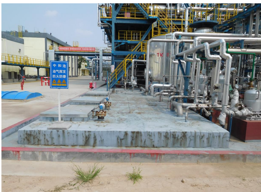
图 3-2 烷基化装置废水中和池
