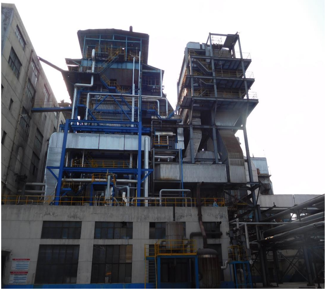
图 3.2 3#燃气锅炉 SCR 脱硝设施
