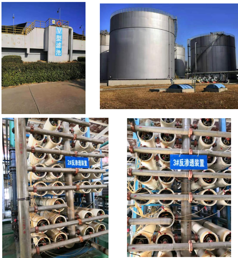
图7 废水净化设施照片
