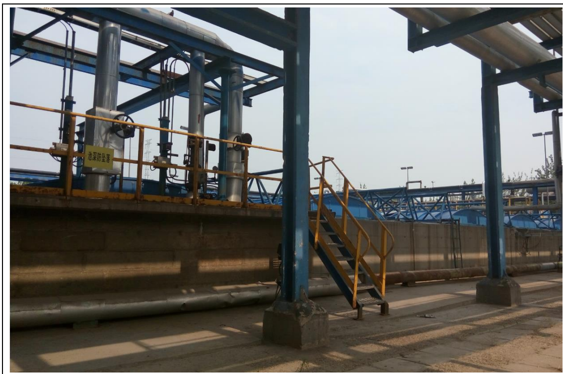
图 3-1 污水处理站现场照片
