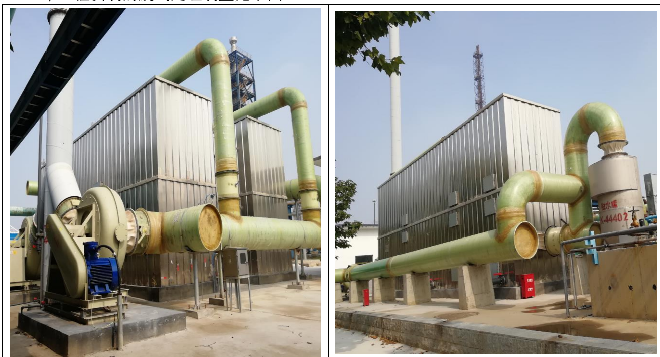
图 3-3 废气处理设施现场照片
