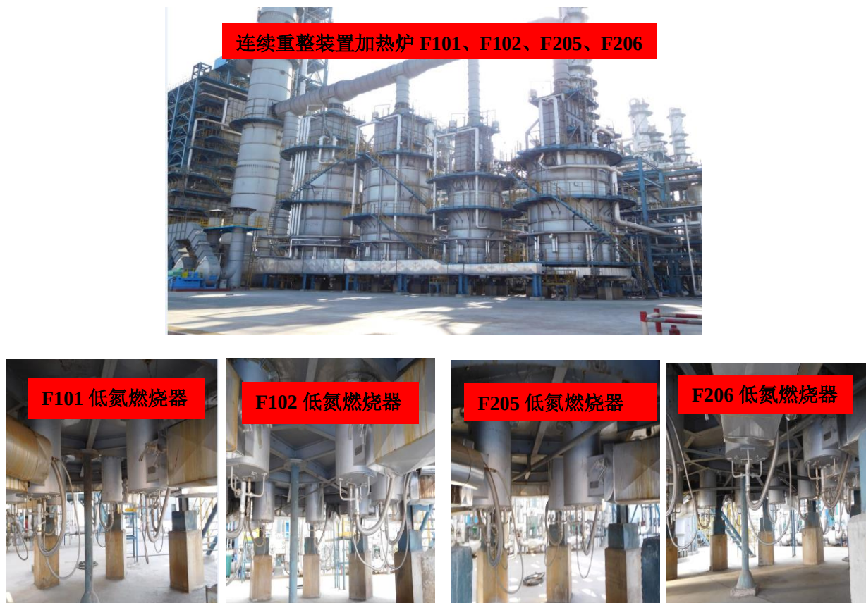
图 3-15 连续重整装置加热炉 F101、F102、F205、F206 及低氮燃烧器
