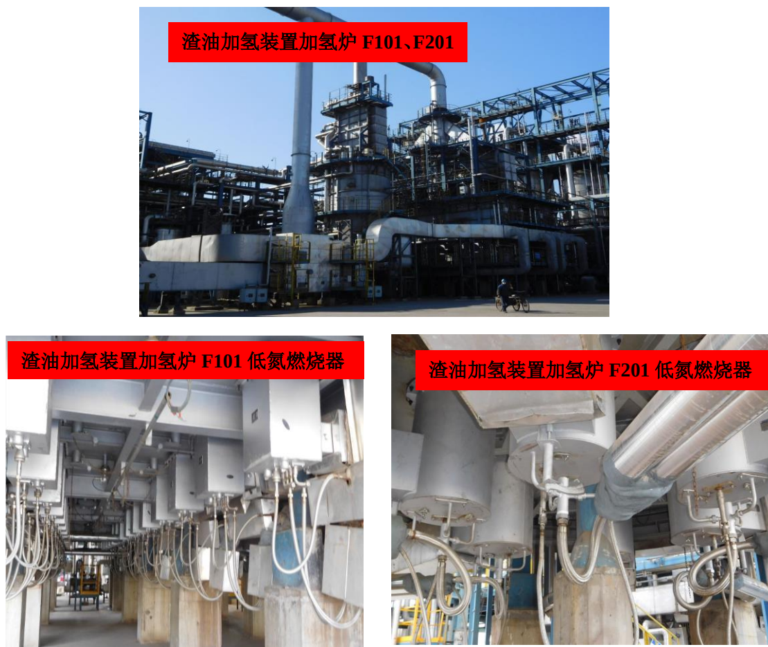
图 3-15 渣油加氢装置加氢炉 F101、F201 及低氮燃烧器
