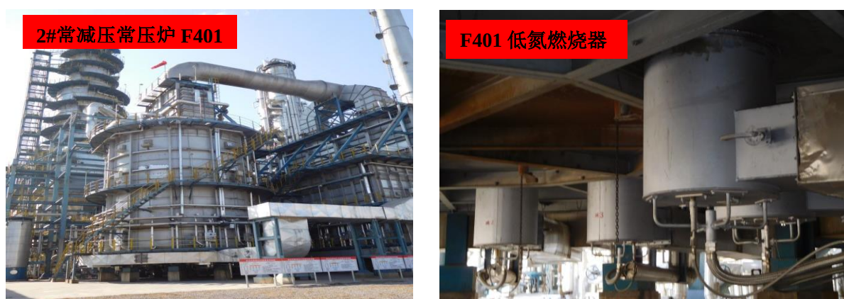
图 3-13 2#常减压常压炉 F401 及低氮燃烧器
