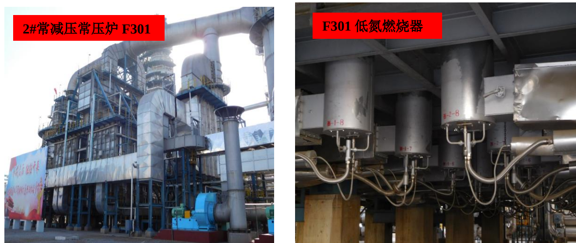
图 3-12 2#常减压常压炉 F301 及低氮燃烧器
