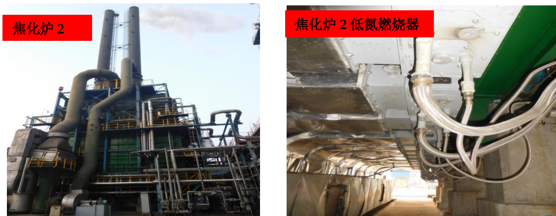
图 3-4 焦化炉 2 及低氮燃烧器
